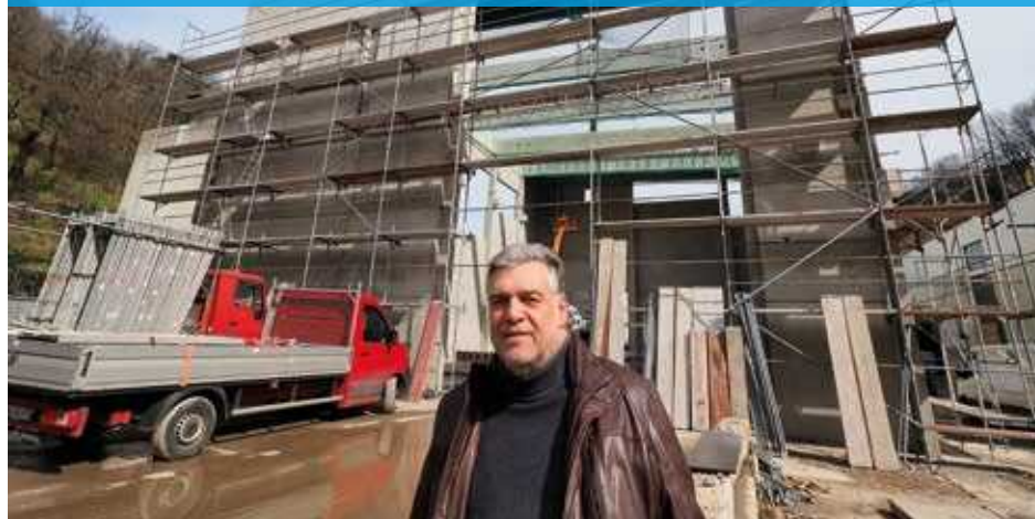
Klincke-Geschäftsführer Bernd Falz steht vor der 20 Meter hohen Halle an der Rahmedestraße, in der später die neue Haubenglühe eingebaut werden soll. Die Glühe steht fertig beim österreichischen Hersteller, kann allerdings aufgrund maroder Autobahnen derzeit nicht transportiert werden. /Klincke Managing Director Bernd Falz stands in front of the 20 metre high hall on Rahmedestraße, where the new bell annealer will later be installed. The annealing furnace is ready at the Austrian manufacturer, but cannot currently be transported due to dilapidated motorways.
