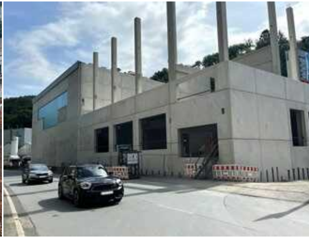
Die Halle für die Glühe steht schon zum Teil. The hall for the annealing furnace is already partially completed
