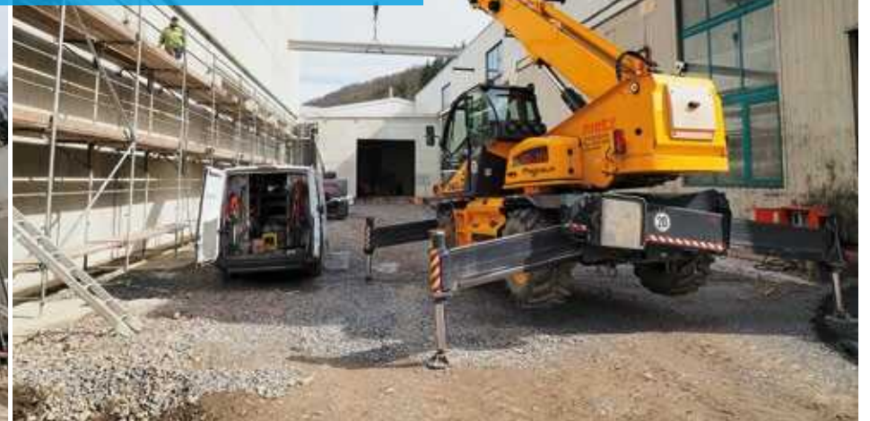
Links im Bild entsteht die neue Halle für die Glühe. Zu den bestehenden Hallen von Firma Klincke rechts und hinten im Bild werden die Freiräume komplett mit Boden und Überdachung geschlossen. /On the left of the picture, the new hall for the annealing furnace is being built. The open spaces between the existing Klincke halls on the right and at the back of the picture will be completely enclosed with a floor and roof.
